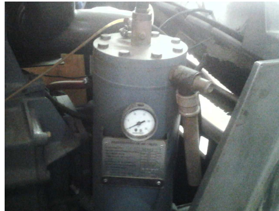
Figura 5: Reservatório de ar e manômetro do filtro de óleo.
